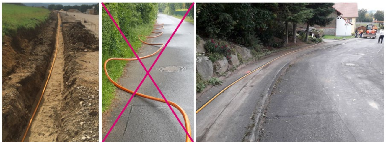
Abbildung 8 Fachgerecht unter Zug gerade ausgelegter SNRV-E und nicht fachgerecht verlegter SNRV-E mit Wellenschlag.
